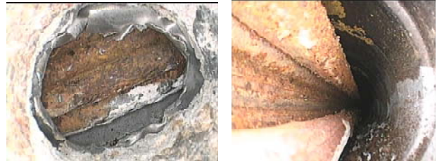
図-8 PC鋼材 腐食度Ⅳ
