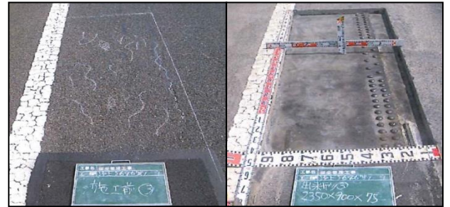
写真-1 損傷の確認（左）舗装厚の確認（右）
