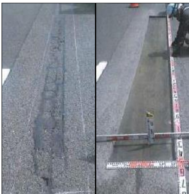
写真-1 損傷の確認（左）舗装厚さの確認（右）
