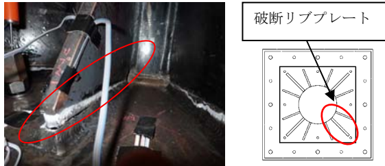
図-9 テレビ支柱 (ベースプレート拡幅) 最大荷重時 (13δy) 基部 (引張側)
