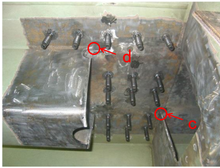
図-9 き裂再発生リスク分析の着目部
