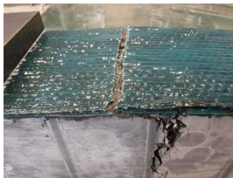
写真-10 炭素繊維シート破断状況
