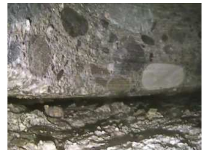
写真-2 PC 舗装版下面の空洞
