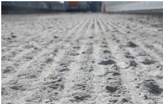
写真-1 切削された床版の表面状態
