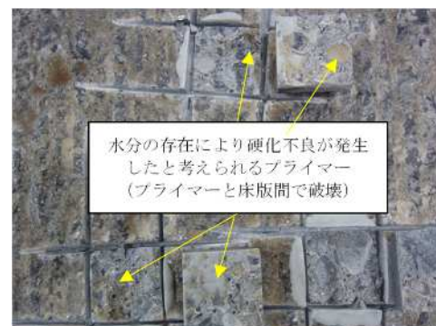
写真-3 水分の存在により硬化不良したと考えられる破壊状態
