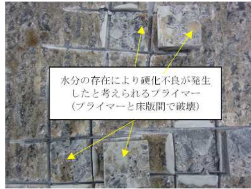
写真-2 切削面処理なし（ダスト有）の破壊状態
