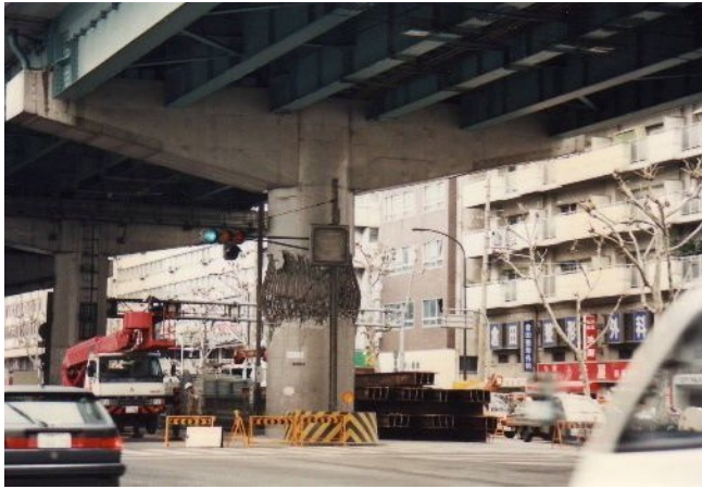
(a) 損傷状況
