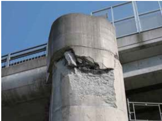
写真-1 変位制限構造橋座取付部の被災事例(植田跨線橋)
