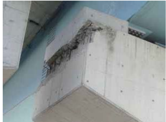
写真-2 変位制限構造橋座取付部の被災事例(亀田大橋)
