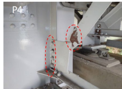
図-8 地震による対傾構のすべり発生事例 8)
