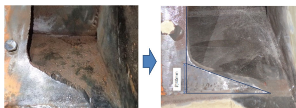
(e) CP切欠き部のき裂への対応(予防保全) 図-3 監視対象とするき裂のこれまでの経緯
