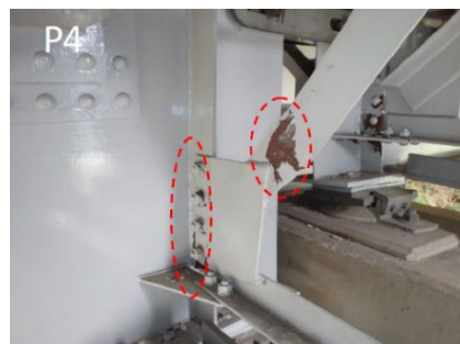
図-8 地震による対傾構のすべり発生事例 6)
