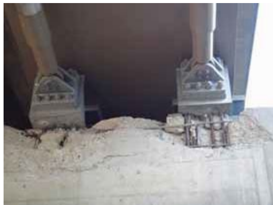
写真-3 制震ダンパー取付部の被災事例(仲ノ瀬橋)
