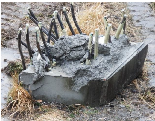
写真5 あと施工アンカーの被災事例(府領第一橋)
