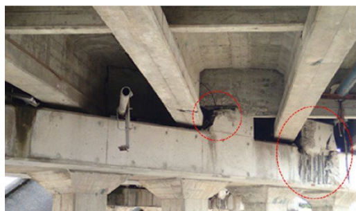
写真7 落橋防止構造取付部の被災事例(鶴飼大橋)
