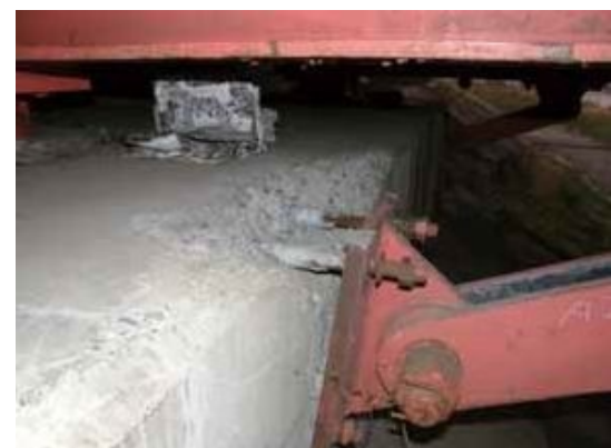
写真-4 あと施工アンカーの被災事例(大正橋)
